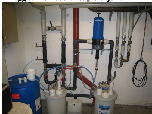
Anlegg som er levert i et pleiehjem.
